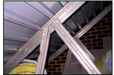
This damaged truss requires a repair. Este truss dañado necesita una reparación.
